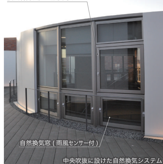
換気制御装置の点検用窓
